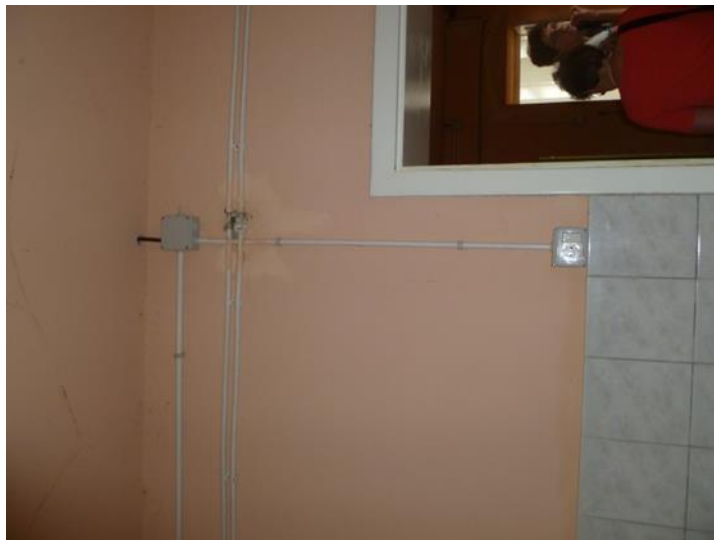
De leidingen in de douche.
